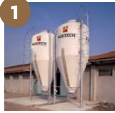
1 Silos in vetroresina con codee flessibili di estrazione. Fibreglass silos with automatic feed conveying system. Silos en fibre de verre avec vis souples d'extraction. Gfk-Futtersilos mit flexiblen Austrageschnecken. Стеклопластиковый силос с системой автоматической транспортировки корма
